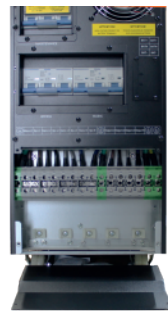
Bypass de Mantenimiento y Borneras
