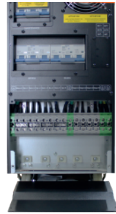
Bypass de Mantenimiento y Borneras
